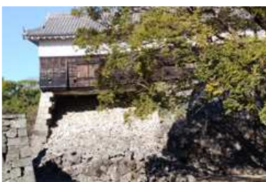
数寄屋丸二階の石垣崩壊
